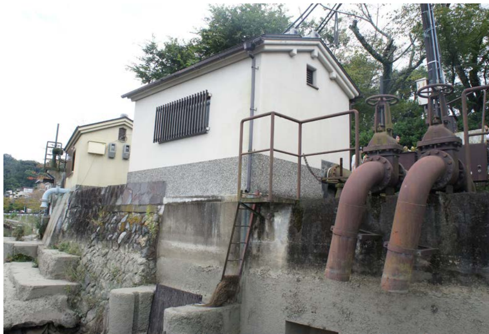
井川用水機場
